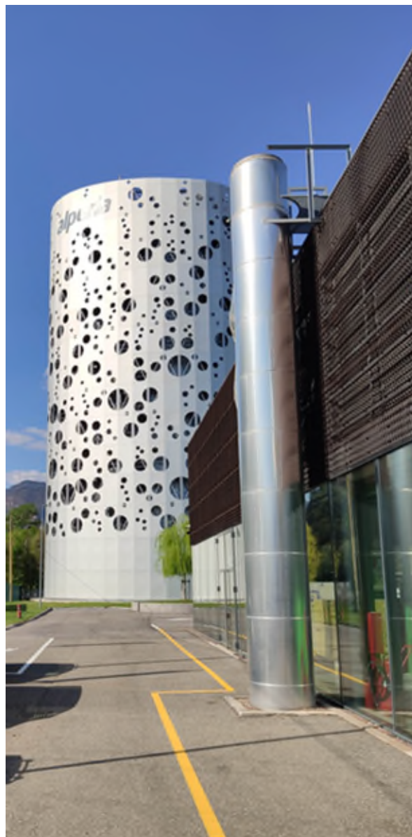
Centrale di Bolzano
