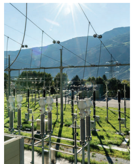
Stazione di trasformazione della centrale di Naturno
