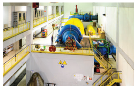
Centrale di Pracomune (sala macchine)
